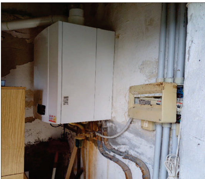
ripostiglio esterno – caldaia
