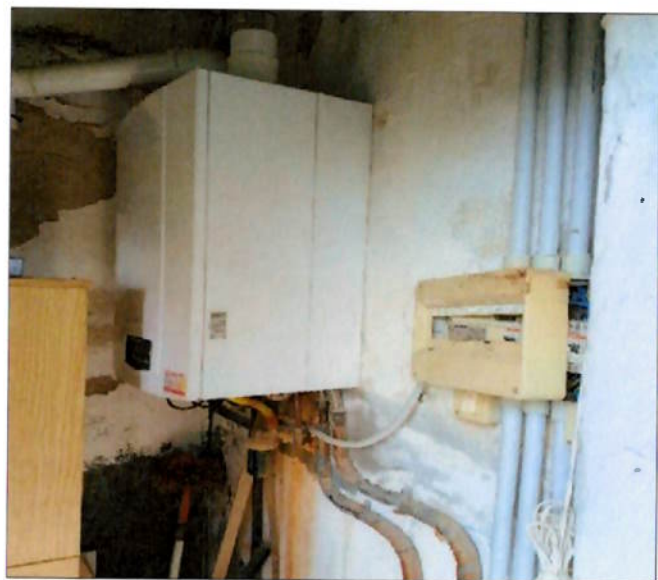
ripostiglio esterno – caldaia
